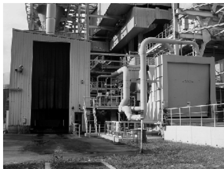
石炭投入口（左）と木質チップ投入口（右）
