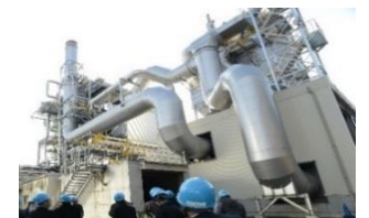
木質バイオマス発電所
